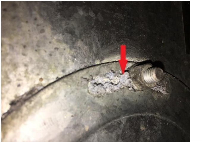
Abbildung 5: Revisionsdeckel mit Asbestprodukt
